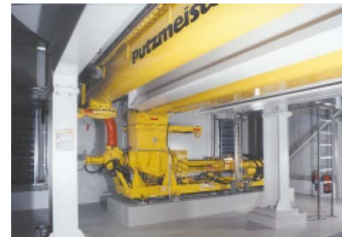
Шламовый насос KOS 1460 с основным и резервным разгрузочным шнеком, установленные под бункером промежуточного хранения осадка V 500 м³
