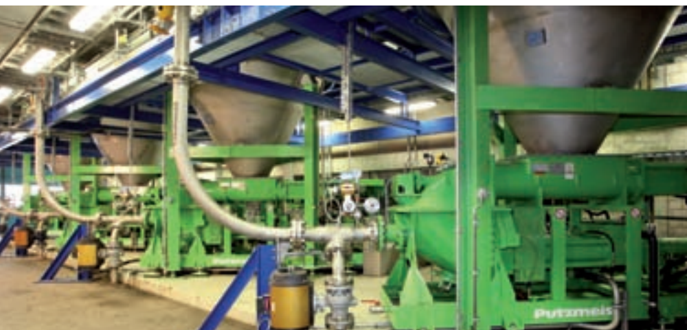
Шламовые насосы KOS 1050 на очистной станции ProRheo (Базель, Швейцария)
