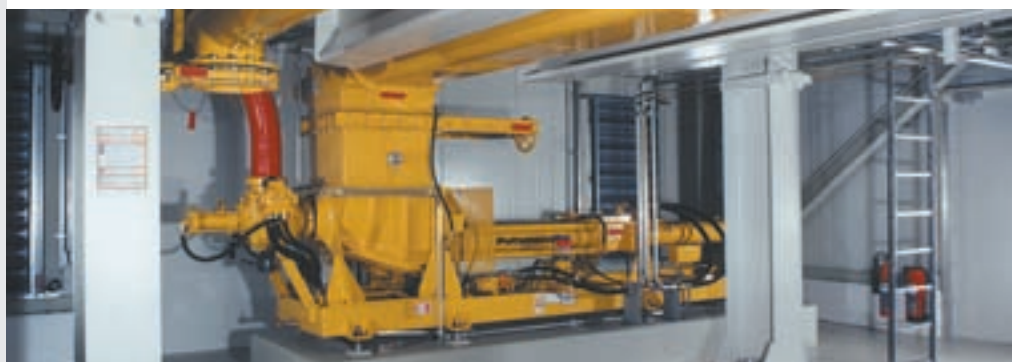
Совместное сжигание шлама очистных сооружений на угольной электростанции в г. Цоллинг, Германия: шламовый насос KOS 2180
