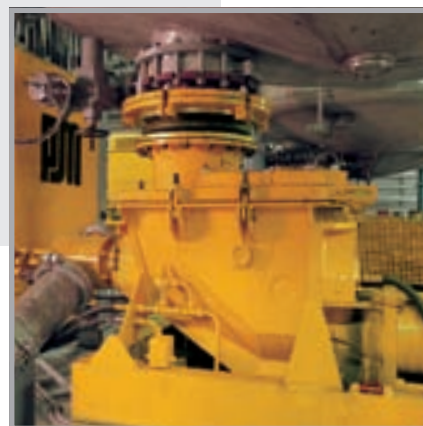
Вверху: Система приёма угольного шлама на электростанции
