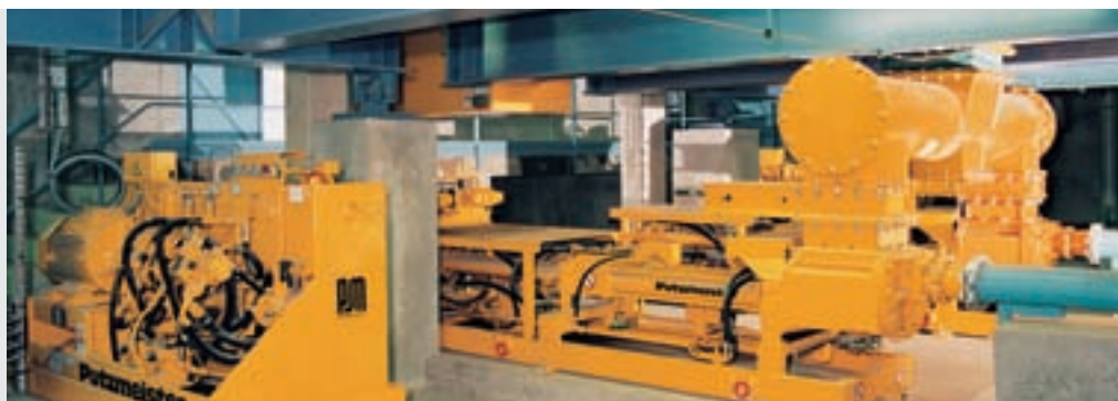
2 поршневых насоса KOS 1030 с НА 22 для подачи шлама очистных сооружений в систему сжигания мусора (Динан, Франция)
