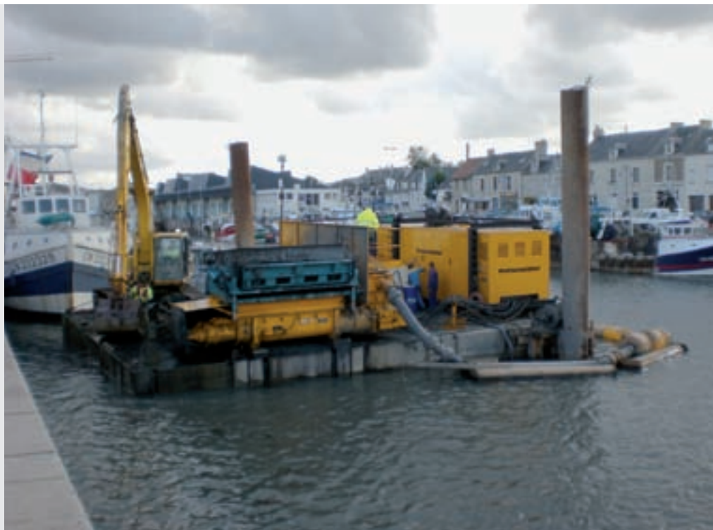
Установка для удаления шлама, оснащённая насосом с S-шибером и гидроагрегатом с дизельным приводом, установлена на понтоне на канале во Франции
